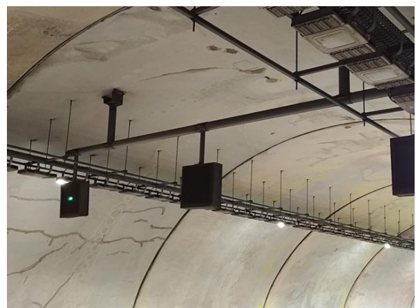
신호기, 조명시설 전경
